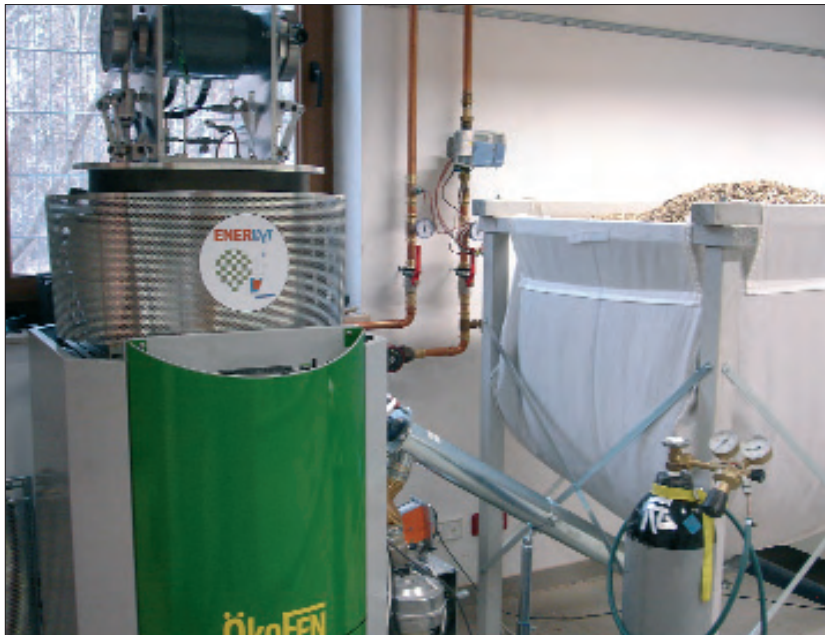
Bild 3. Enerlyt-Stirling auf einem Holzpelletkessel
